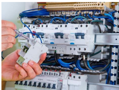
Rys. 5. Widok stanowiska dydaktycznego szafy rozdzielczej [2]
