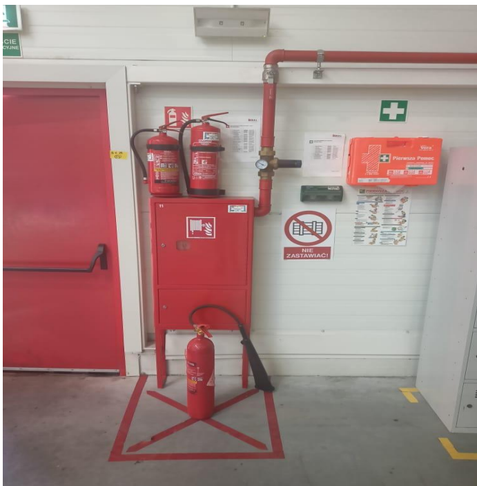
Rys. 8. Punkt gaśniczy przy linii FL 040 (opracowanie własne)
