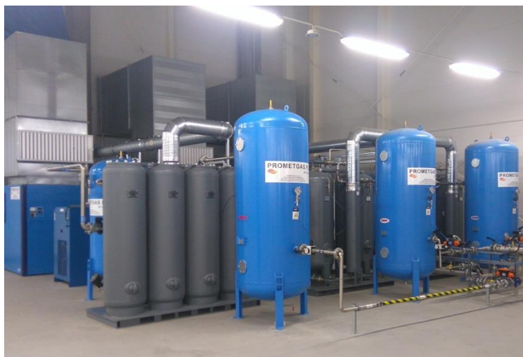
Rys. 8. Generator azotu w systemie inertyzującym [14]
