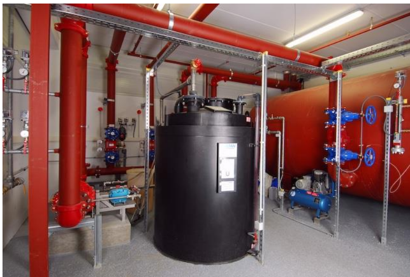
Rys. 6. Zbiornik z substancją pianotwórczą podpięty do instalacji tryskaczowej/zraszaczowej [25]
