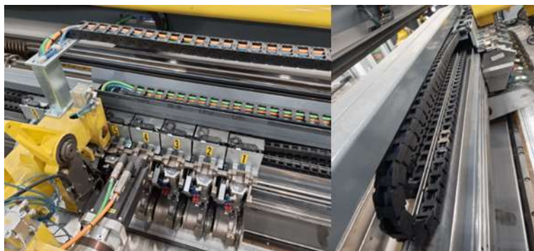
Rys. 5. Prowadnice przewodów elektrycznych i pneumatycznych [fot. T. Modrzyk].
