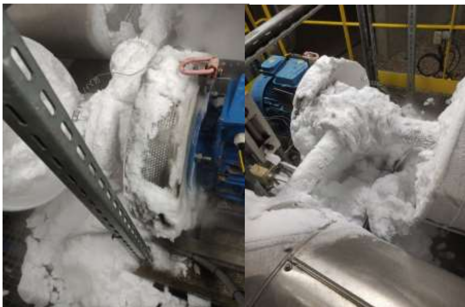
Rys 1. Obladzona pompa załadunkowa azotu, uszkodzone uszczelnienie na pompie załadunkowej azotu.
