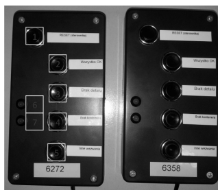
Rys. 5. Interfejs urządzenia typu KLIENT1 montowanego na gniazdach produkcyjnych
